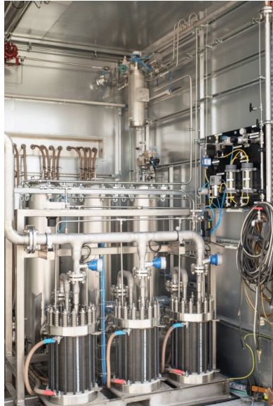
The PEM electrolyser
